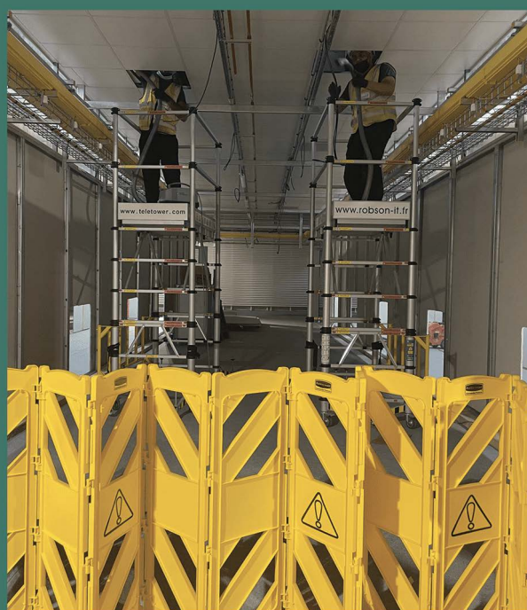
Teletower avec garde-corps
